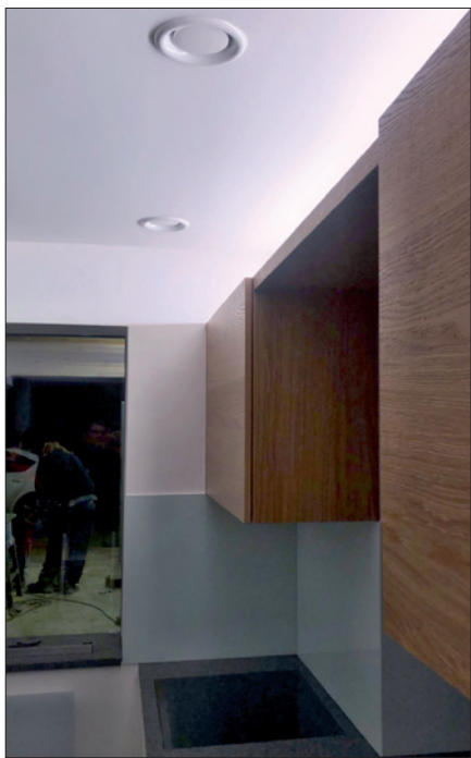
Obr. 12. Skříňky v kuchyni byly sníženy ve prospěch instalace nepřímého osvětlení. Na stropě je výustek řízeného vícezónového větrání s rekuperací tepla v zimě a chladu v létě
