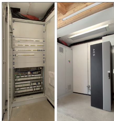
Obr. 4. Technická místnost. Vlevo rozváděč silnoproudu s řídicím systémem Foxtrot firmy Tecco ve třech řadách dole. Vpravo ve skříni s označením AES bateriové úložiště s hybridním měničem firmy AERS.
